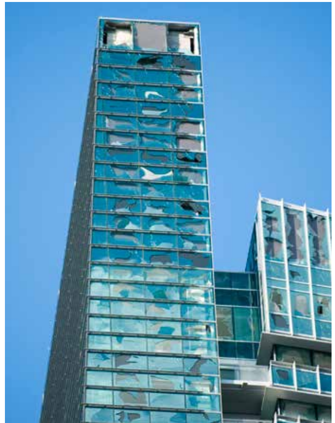
Hohe Windgeschwindigkeiten und von Hurrikans aufgewirbelte Trümmerteile können ein Gebäude in wenigen Stunden zerstören, wie die Aufnahme des Bankgebäudes in Brickell Avenue nach dem Hurrikan Wilma zeigt.
